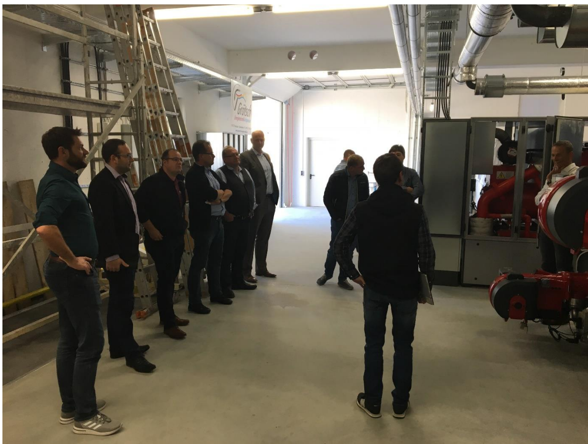
Foto: Die Teilnehmer folgen gespannt den Ausführungen des technischen Leiters der HEWA GmbH, Herrn Harald Günzrodt, in der Heizzentrale. Zu erkennen ist das Blockheizkraftwerk (BHKW) am rechten Bildrand.
